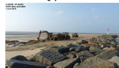
Zone d'accrétion dans le chenal d'accès du port de Port-Bail-sur-Mer - © Cerema
