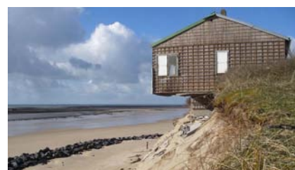
Affouillement sous une maison à St-Germain-sur-Ay © DDTM50
